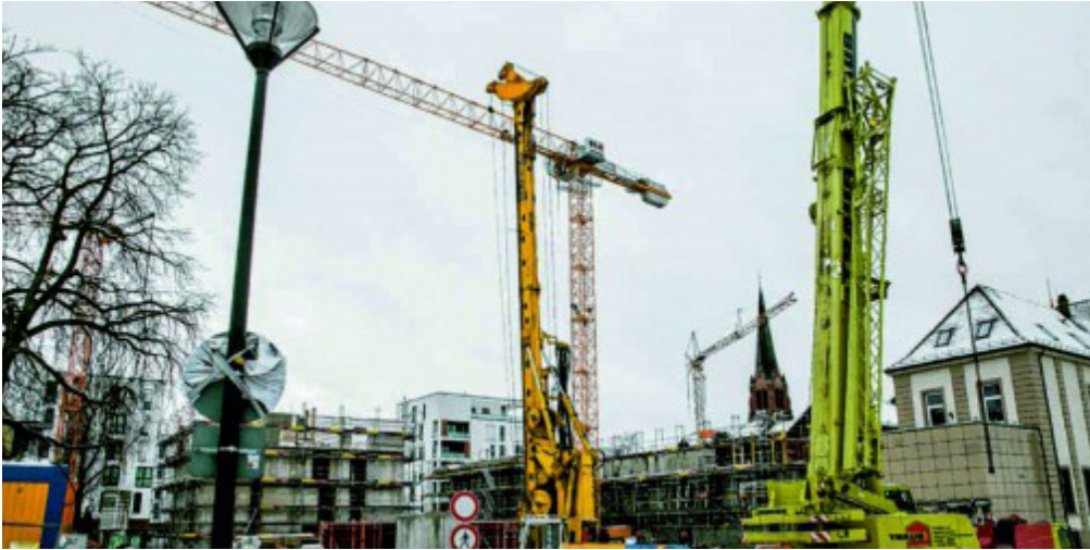
Im östlichen Bereich des zweiten Bau-feldes „An der Stadtwaage“ beginnen jetzt die Gründungsarbeiten. Foto: Christian Thumm
